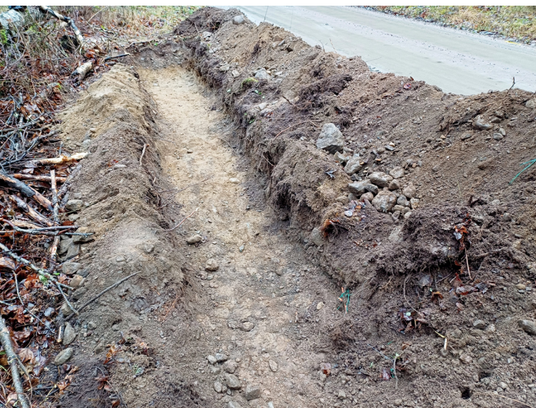
Figur 5. Schakt 1. Nere till höger i bild syns skymta markeringsband och nedlagd fiberkabel. Foto från söder.
