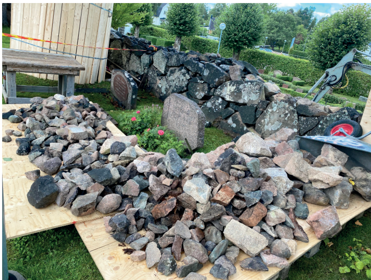
Figur 5. Sten nedplockade från muren i väntan på att kontrolleras. Foto från nordöst.
